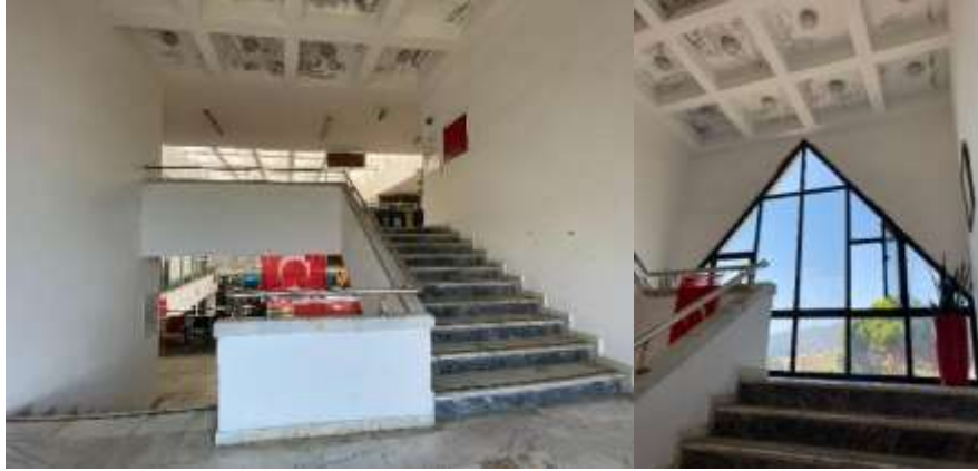
Yapıdaki Hasarlar (İsmailoğlu, 2022)
