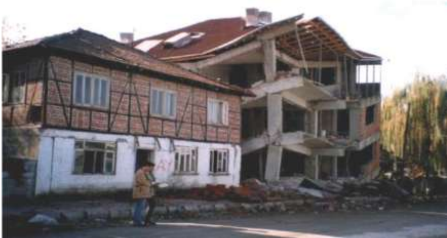
Şekil 6: 1999 depreminde Kaynaşlı’da ahşap hımmış ve betonarme iki evin durumu (URL-6).
