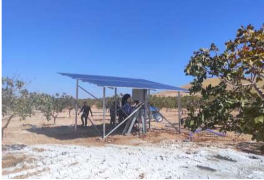
Şekil 5. Kurulumu Tamamlanan Fotovoltaik Panel
