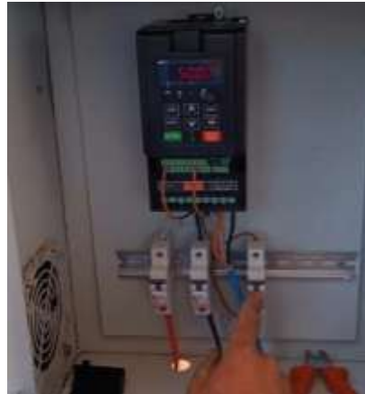
Şekil 6. Sistemde Kullanılan Solar Sürücü (İnverter) ve Pano İç Dizaynı.
