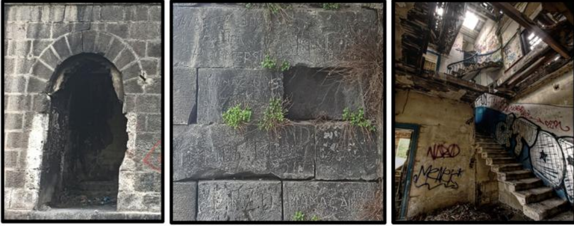
Şekil 3. İnsan kaynaklı bazı yapı hasarı örnekleri
