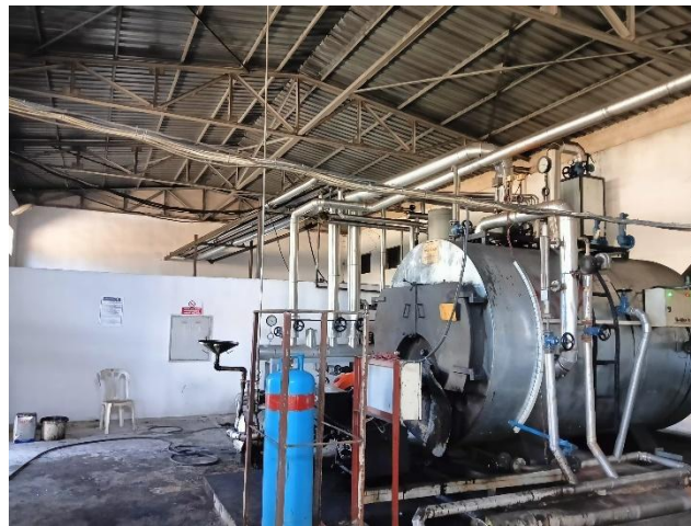
Şekil-2: İnceleme Yapılan Buhar Kazanı
