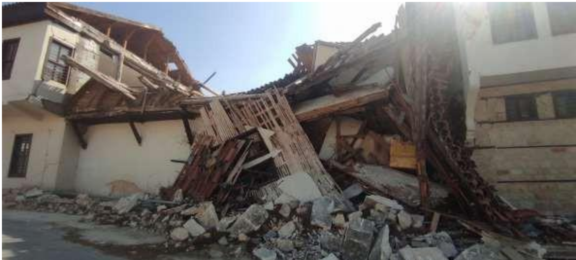
Şekil 7 de verilen örnek gibi geleneksel ahşap konut mimarisi ile inşa edilmiş ve konutun deprem sonrasında yığma taş ile yapılmış bahçe duvarlarının yıkılmasına rağmen sismik yükler altında bütünlüğünü korumaya devam ettiği görülmüştür.
