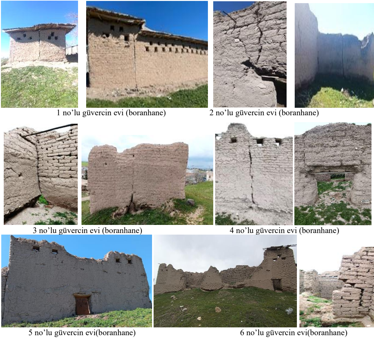
Şekil 3.9. Güvercin evlerinde (boranhane) deprem etkisiyle oluşan strüktürel çatlaklar ve ayrışmalar
