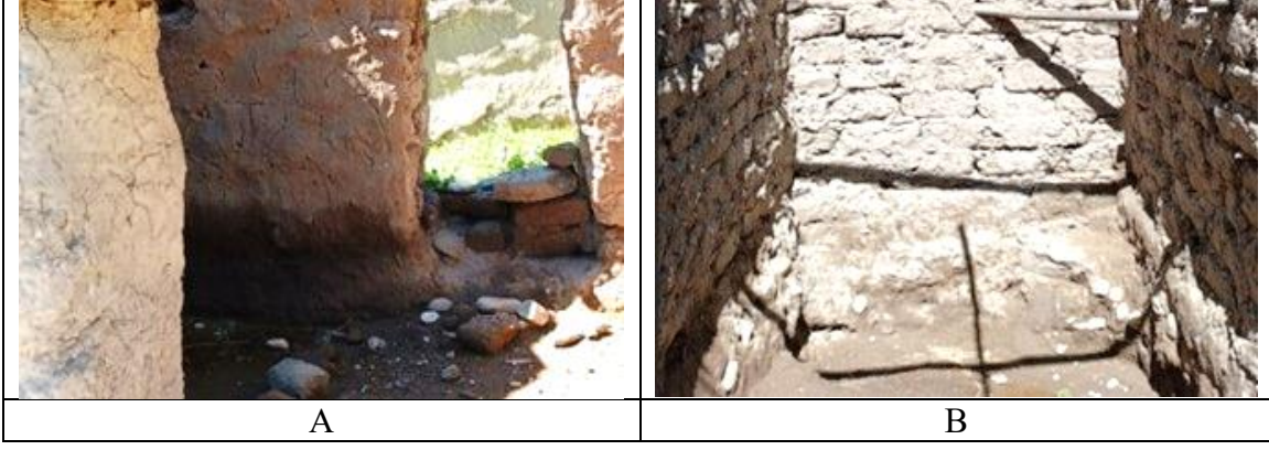
Şekil 3.5. 5 numaralı güvercin evinde (boranhane) meydana gelen hasarlar
