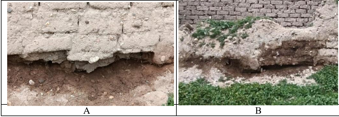
Şekil 3.6. 6 numaralı güvercin evinde (boranhane) meydana gelen hasarlar
