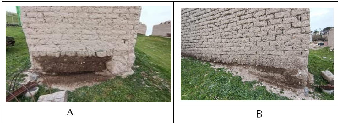
Şekil 3.4. 4 numaralı güvercin evinde (boranhane) meydana gelen hasarlar
