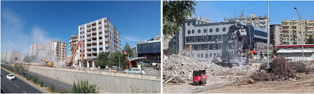
Şekil 2.7. Diyarbakır kent merkezinde yıkılan ağır hasarlı binalar (2024)
